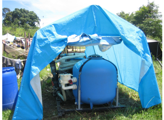
Vattenreningsanläggning i Aceh i Indonesien (Källa: Revisionsrätten)
