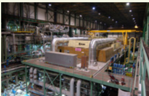
2011 m. turbinų salė su turbinomis © „Javys“.
