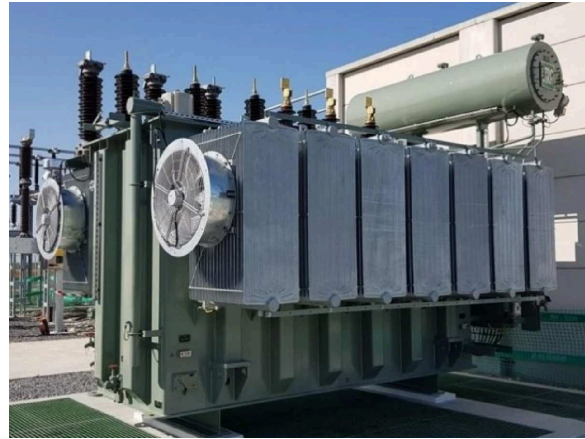
Radiadores en un transformador
