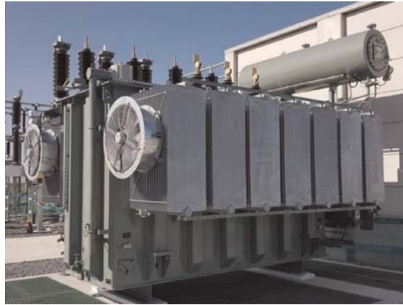
Auf einem Transformator montierte Radiatoren
